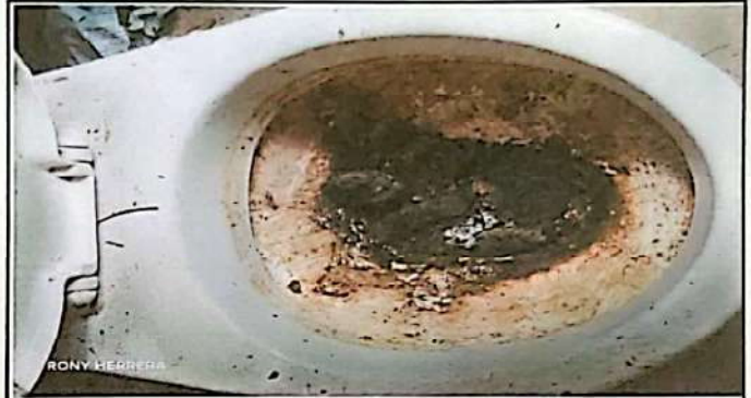
Foto 2: Tasa y accesorios en malas condiciones.
