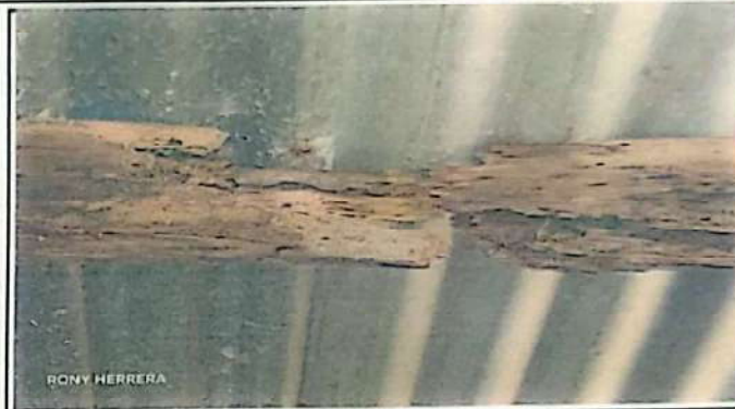
Foto 2: Estructura de techo deteriorada
