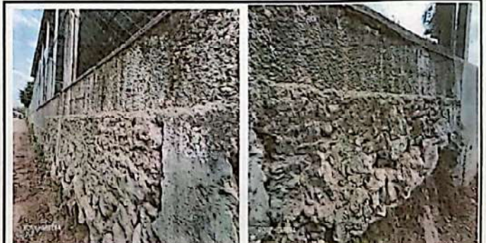
Foto 6: Pared deteriorada y muro de contencion deteriorado.
