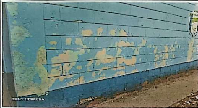
Foto 1: Pintura en malas condiciones.
