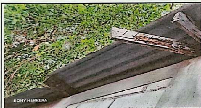
Foto 3: Estructura de metal deteriorada
