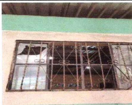
Foto 1: Sustrucción de 26 unidades de vidrios de 3 ventanas.
