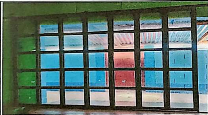
Foto 3: Ventana en mal estado
