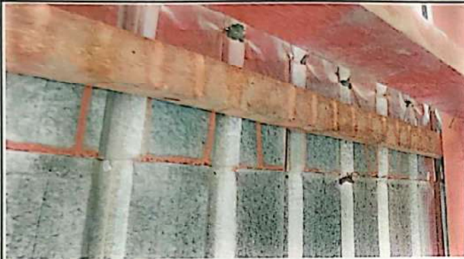
Foto 1: Techo en mal estado
