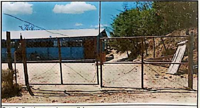
Foto 6: Portón en malas condiciones
