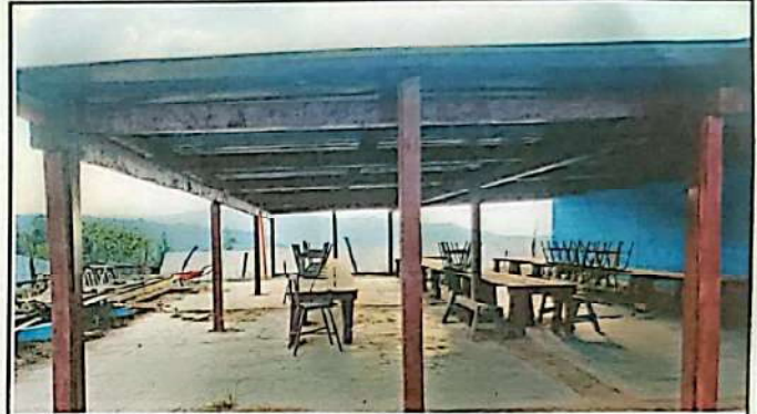
Foto 2: Estructura del techo en malas condiciones
