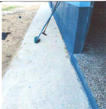
Foto 7: Torta de cemento en buen estado
