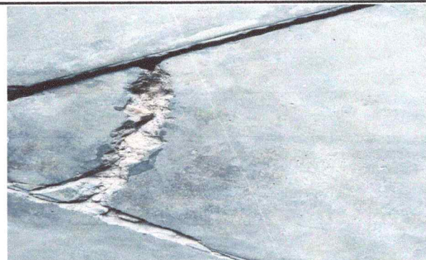
Foto 8: Piso en mal estado
