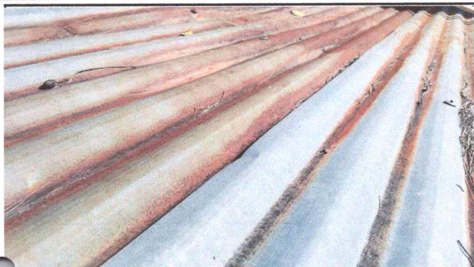
Foto 1: Lámina en mal estado
