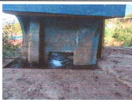
Foto 4: Pila en mal estado
