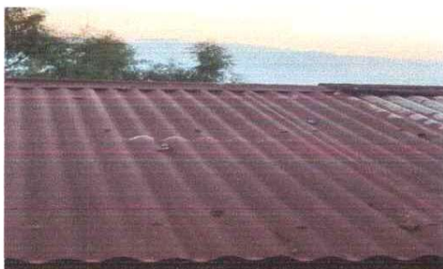
Foto 1: Laminas en mal estado
