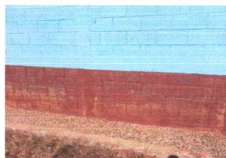
Foto 6: Pintura en mal estado
