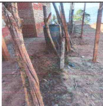
Foto 1: Maya en mal estado
