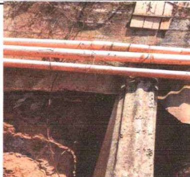
Foto 2: Tubos para aguas negras deteriorados
