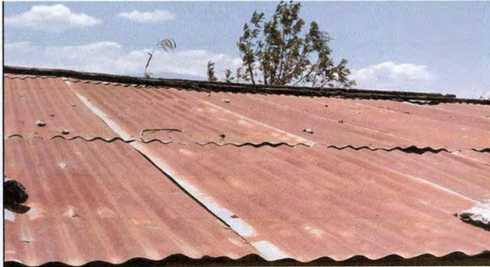
Foto 1: Techo en malas condiciones
