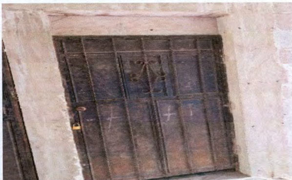
Foto 3: Puerta de metal en mal estado
