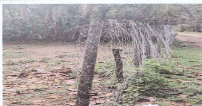
Foto 8: Circulacion con malla en mal estado.
