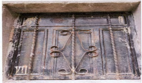
Foto 4: Ventanas en pesimas condiciones
