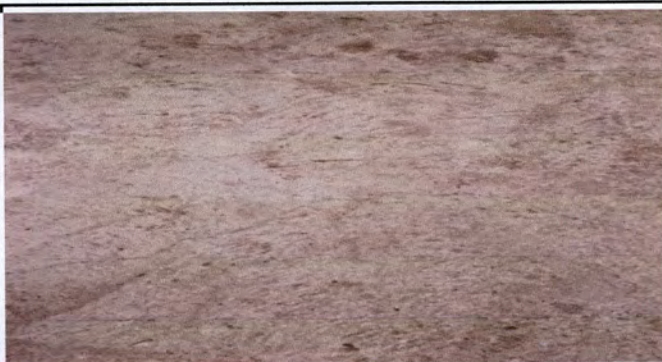
Foto 5: Piso en mal estado
