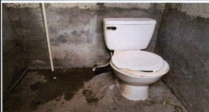
Foto 7: Servicios sanitarios y accesorios en mal estado
