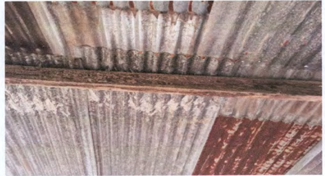
Foto 2: estructura de techo en mal estado.
