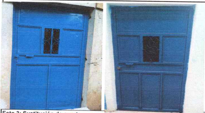
Foto 3: Sustrucción de puerta
