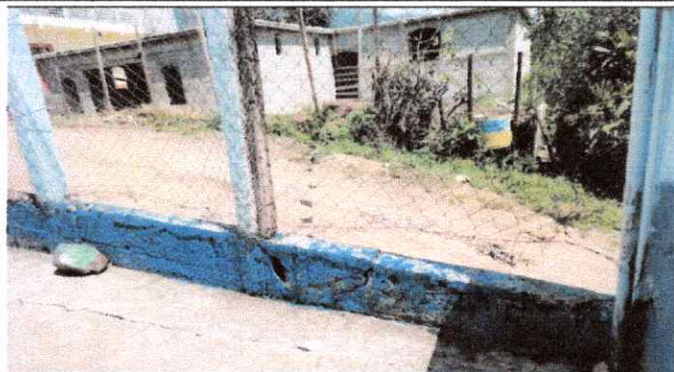
Foto 7: Malla en mal estado.
