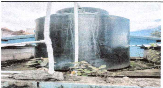
Foto 9: Depósito de agua deteriorado.
