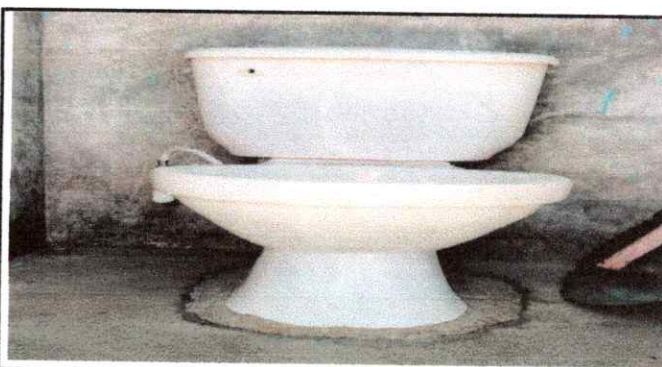
Foto 6: Inodoro en mal estado y quebrado.
