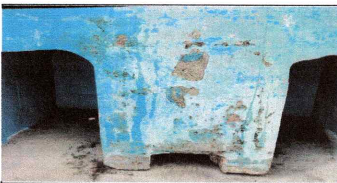
Foto 11: Pila deteriorada y quebrada.
