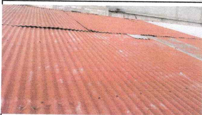
Foto 1: Lámina en mal estado.
