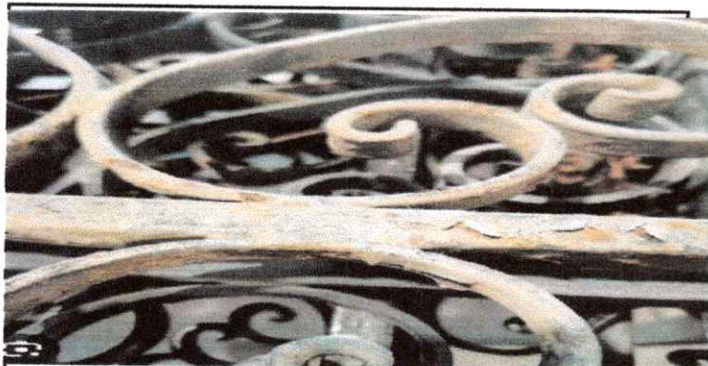
Foto 3: Balcones en mal estado.
