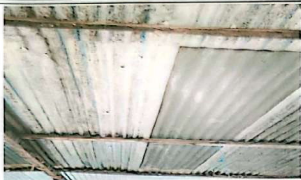
Foto1: Lámina en mal estado
