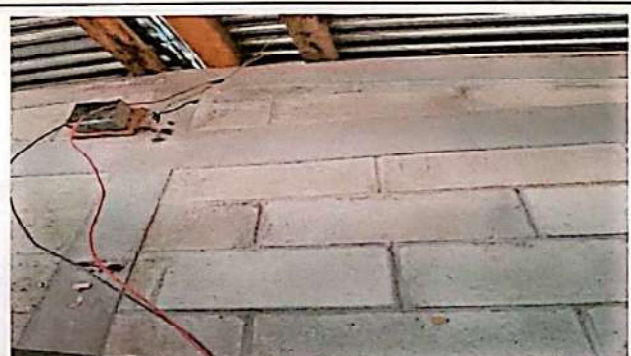
Foto 12: Cableado eléctrico en mal estado
