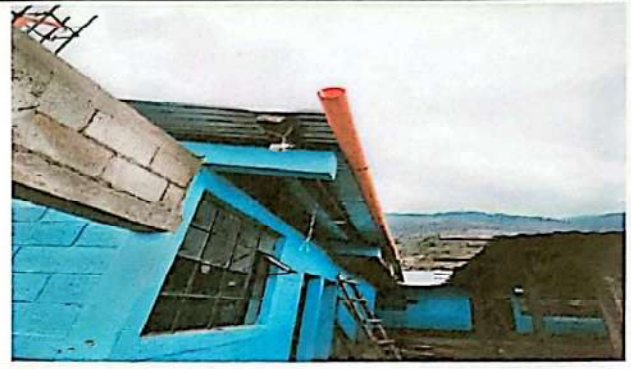
Foto 8: Canal de metal en mal estado
