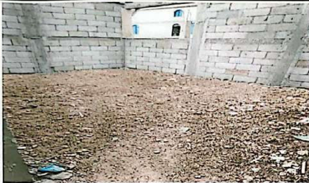
Foto 7: Piso en mal estado
