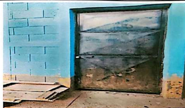
Foto 4: Puerta de metal en mal estado
