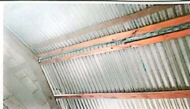
Foto 2: Soporte de madera en mal estado
