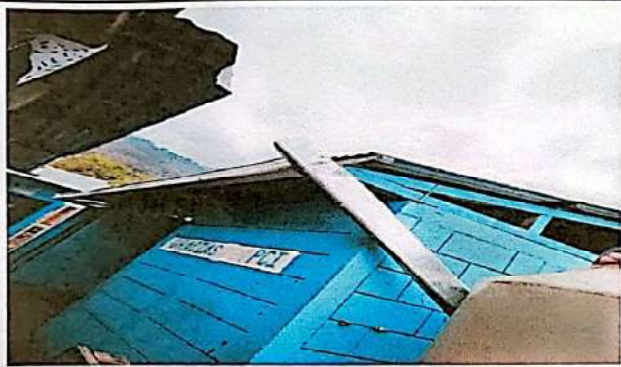
Foto 9: bajada de agua pluvial tubo PVC en mal estado
