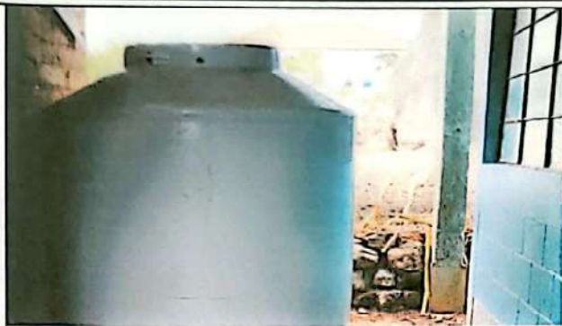
Foto 13: Depósito de agua en mal estado
