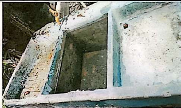
Foto 10: Pila en mal estado
