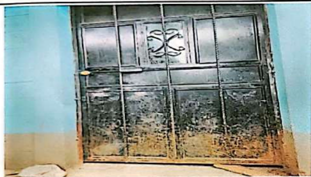
Foto 3: Estructura en mal estado
