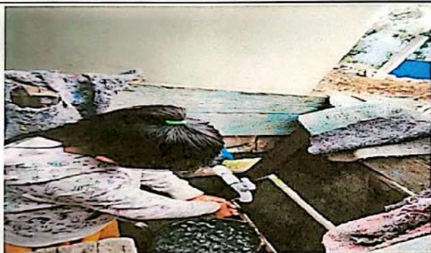
Foto 15: Lavamanos en mal estado
