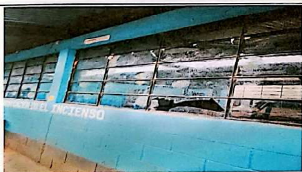
Foto 5: Ventana de metal en mal estado
