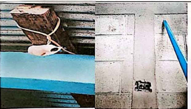
Foto 11: Plafoneras e interruptores en mal estado
