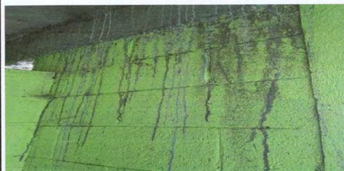
Foto 4: Pintura en mal estado
