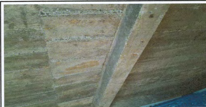
Foto 6: Repello en mal estado
