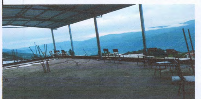
Foto 6: peligro; parte suroeste donde se pondrá muro perimetral
