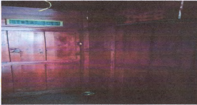
Foto 1: puertas inseguras; es necesario instalar puertas de metal
