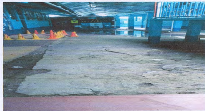
Foto 3: piso en mal estado (es necesario piso nuevo)
