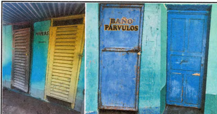
Foto 3: Puertas en mal estado.
