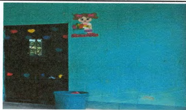
Foto 6: Pintura de pared de aulas en mal estado
