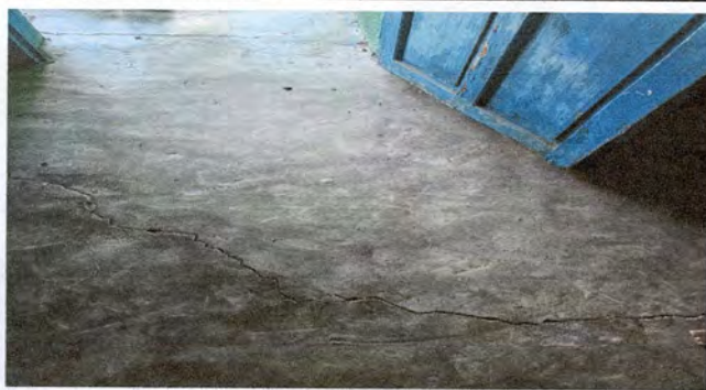
Foto 5: Piso de aulas en mal estado
