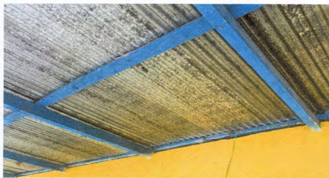
Foto 2: Madera en mal estado
