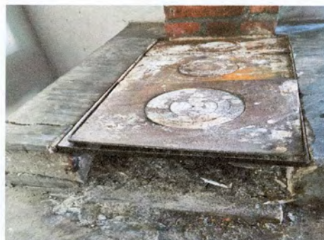
Foto 10: Plancha en mal estado, azulejos despegados.
