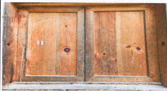
Foto 4: Ventanas en malas condiciones.
