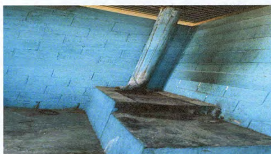
Foto 6: Plancha y chimenea en mal estado
