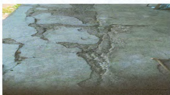
Foto 4: Piso en mal estado.
