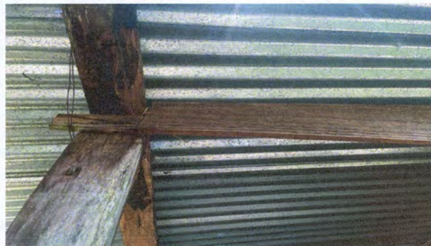
Foto 2: Estructura de techo en mal estado
