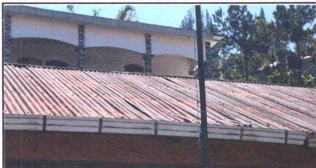
Foto 1: Lámina en mal estado oxidadas de las aulas, en época de lluvia filtran gotas hasta pequeños chorritos de agua. En la zona llueve en horario escolar, lo que dificulta el desarrollo de las clases.
