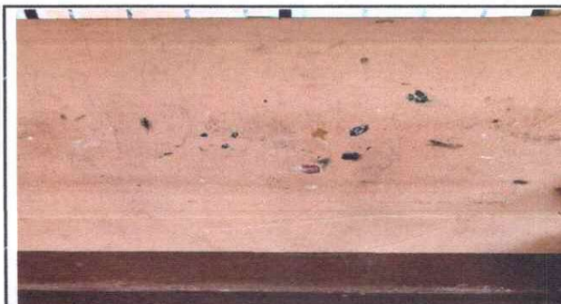
Foto 6: Paredes de las aulas manchadas, que no propician un ambiente agradable.
