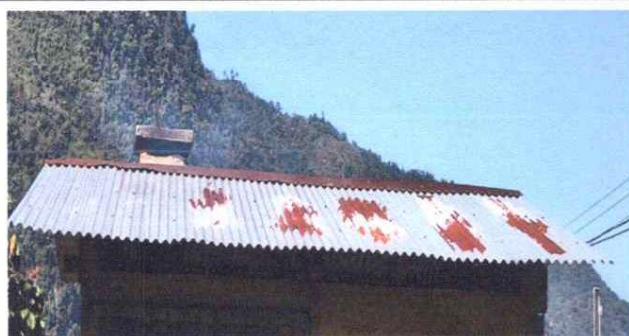
Foto 3: Lámina de cocina, en mal estado oxidada y desalineada. Existe filtración de agua en época de lluvia.
