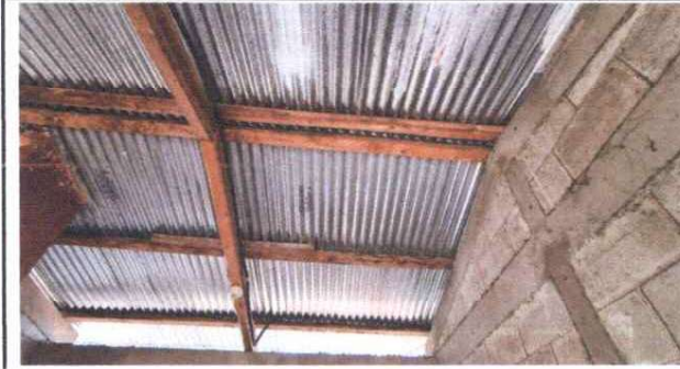
Foto 4: Estructura de cocina de madera, colocados no tan seguros, debido a la añadidura de vigas.
