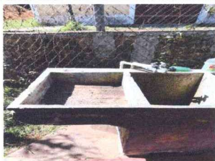
Foto 7: pila en mal estado, la parte del lavado está lisa y apunto de destruirse la parte cementada.
