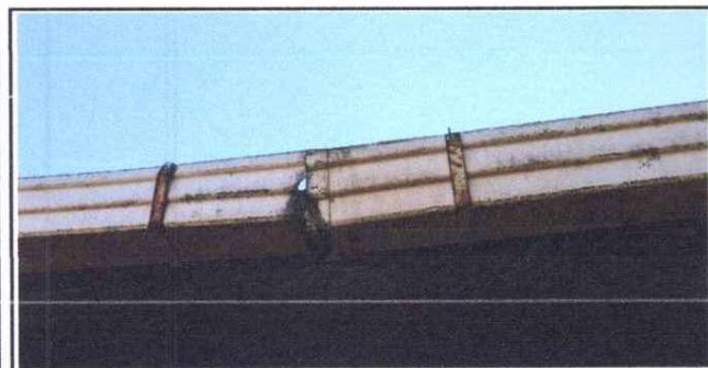
Foto 5: Bajada de agua pluvial quebradas en mal estado, ya no cumplen con su función específica.
