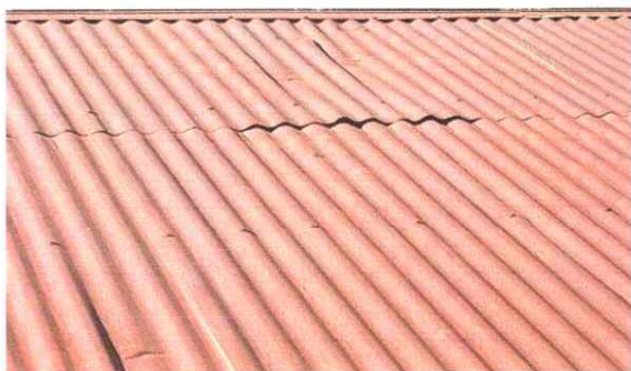
Foto1: Láminas en mal estado
