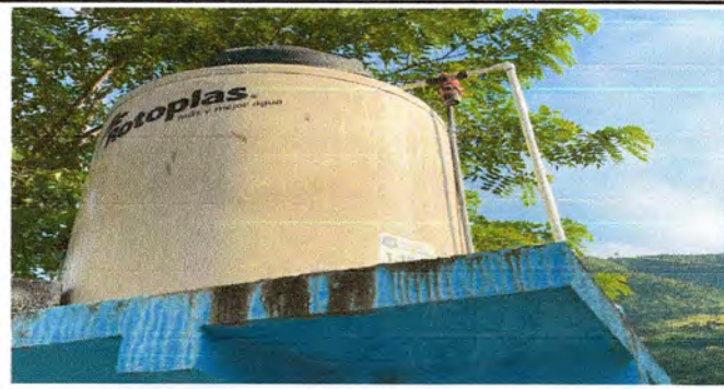
Foto 6: depósito de agua deteriorado
