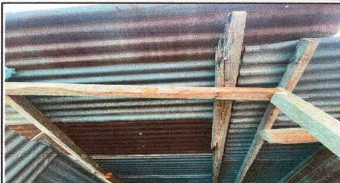
Foto 2: Madera en mal estado
