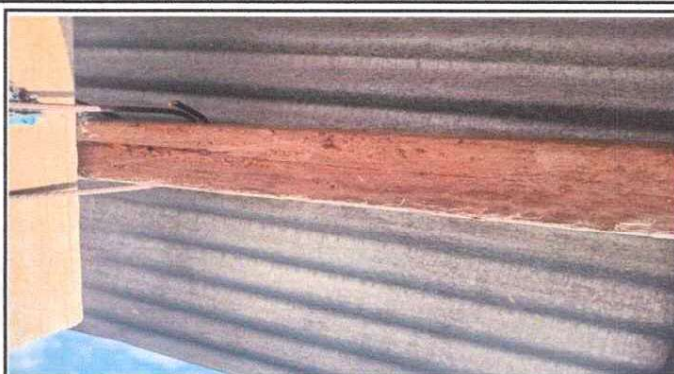
Foto 2: Estructura de techo en mal estado
