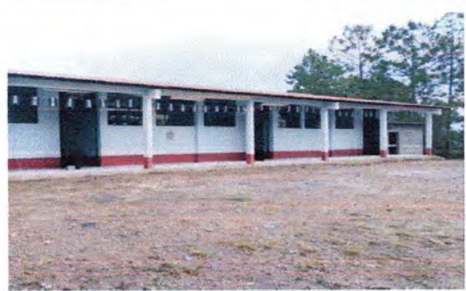
Foto 2: Lamina deteriorada y daño en canales y bajadas de agua pluvial
