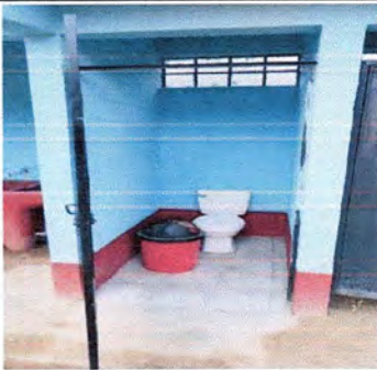
Foto 3: Inodoros de baños en mal estado.
