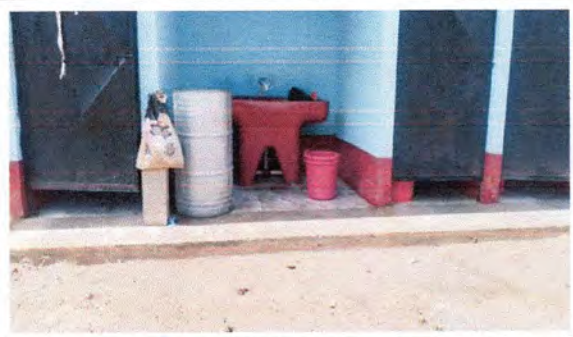
Foto 4: Puertas, pilas y baños en mal estado,
