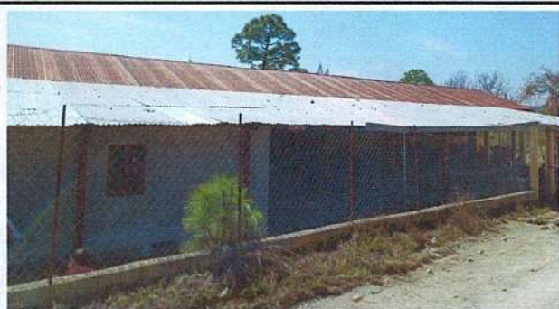
Foto 1: Cubierta de lámina deteriorada
