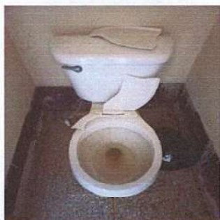
Foto 5: Servicios sanitarios deteriorados
