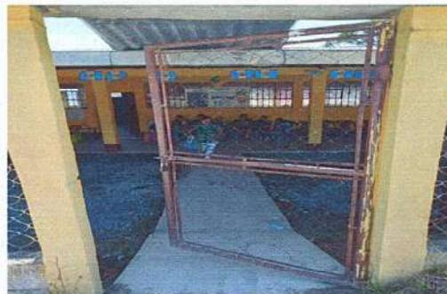
Foto 4: Pintura deteriorada en todo el centro educativo
