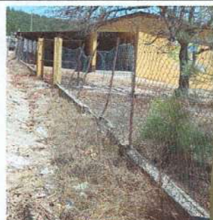
Foto 6: Muro perimetral en malas condiciones
