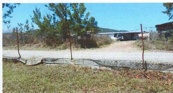
Foto 2: Muro perimetral en malas condiciones
