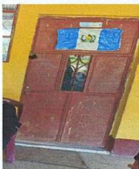
Foto 3: Puertas de metal en mal estado
