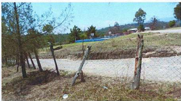
Foto1: Muro perimetral en malas condiciones
