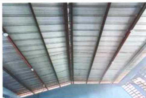
Foto 6: Sistema eléctrico instalado
