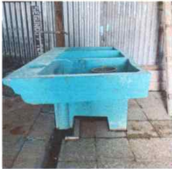
Foto 7: Pila de cemento instalada
