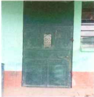
Foto 1: Puertas de metal en mal estado
