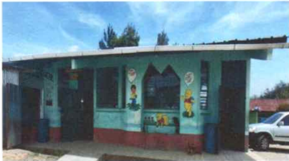
Foto 3: Canal de PVC en mal estado
