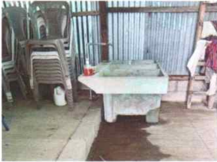
Foto7: Pila de cemento en mal estado
