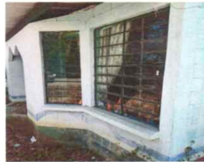
Foto 4: Pintura deteriorada en todo el centro educativo
