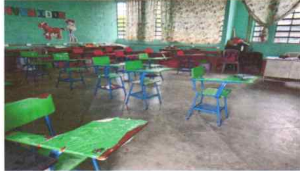
Foto 2: Piso de cemento liquido deteriorado
