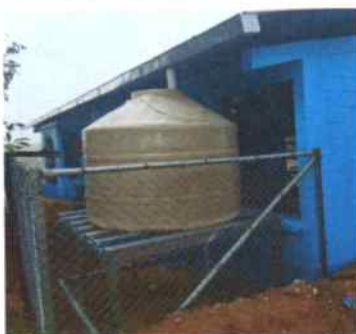
Foto 9: Depósito de agua instalado
