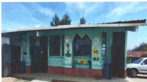
Foto 3: Canal de PVC en mal estado
