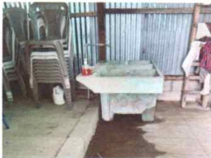
Foto7: Pila de cemento en mal estado
