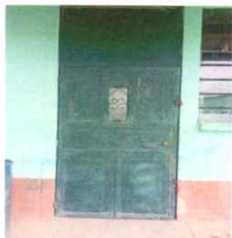
Foto1: Puertas de metal en mal estado
