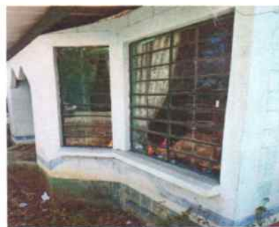
Foto 4: Pintura deteriorada en todo el centro educativo
