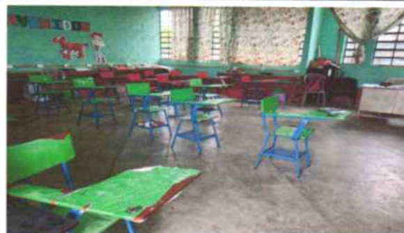
Foto 2: Piso de cemento liquido deteriorado
