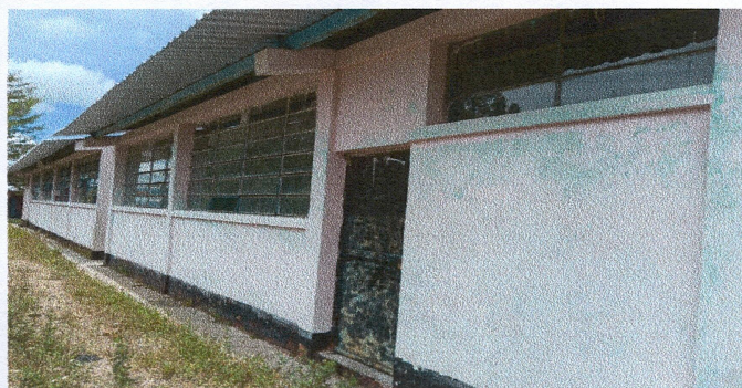
Foto 3: Ventanas sin balcones y vidrios quebrados.
