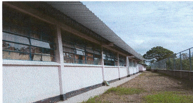
Foto 2: Ventanas sin balcones y vidrios quebrados.
