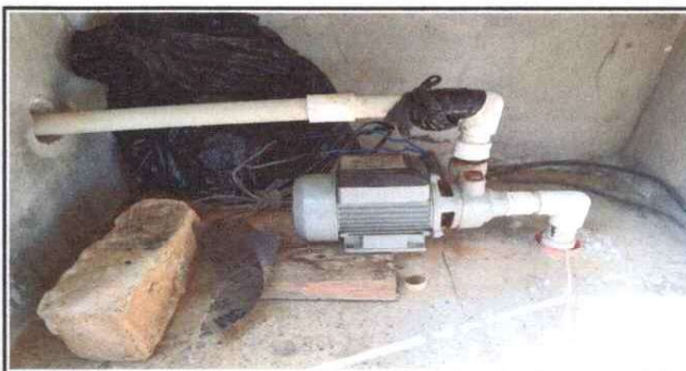
Foto 6: Bomba de agua deteriorada
