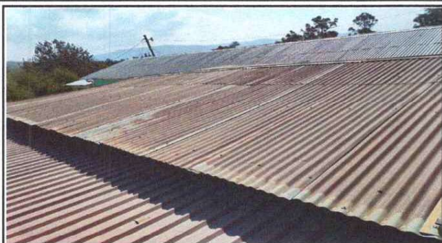
Foto 1: Cubierta de lámina deteriorada
