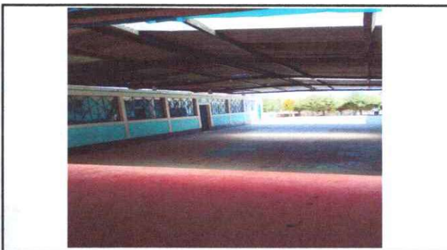
Foto 4: Bases de concreto necesitan mejoramiento
