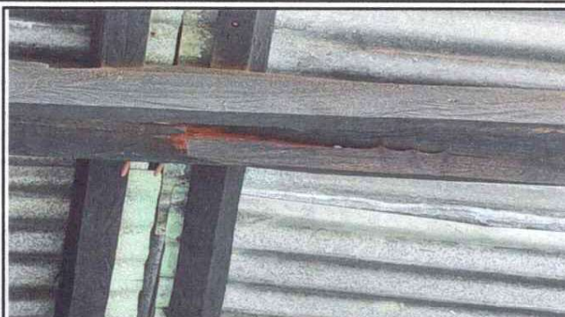
Foto 2: Estructura de soporte de madera deteriorada
