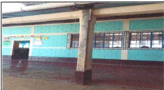
Foto 3: Bases de concreto necesitan mejoramiento
