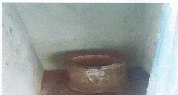
Foto 3: Sustrucción por sanitarios lavables
