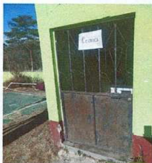
Foto 3: Puerta de metal de cocina en mal estado
