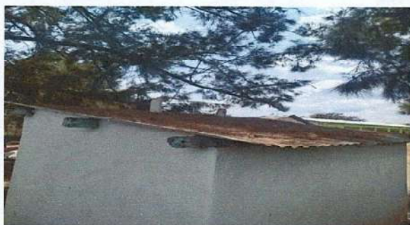
Foto 1: Lámina en mal estado
