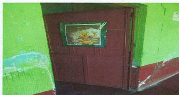
Foto 2: Pintura de todo el centro educativo con hongos y en mal estado
