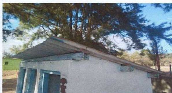
Foto 2: Estructura de madera en mal estado
