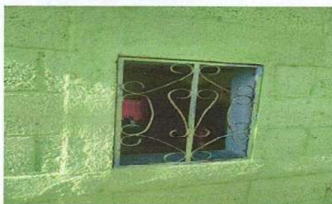
Foto 4: Estructura de la ventana de la cocina en mal estado
