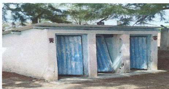
Foto 3: Puertas de servicios sanitarios en mal estado
