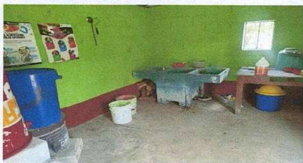
Foto 1 : Piso líquido de cocina en mal estado
