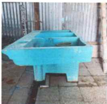
Foto 7: Pila de cemento instalada
