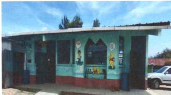
Foto 3: Canal de PVC en mal estado
