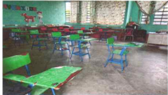
Foto 2: Piso de cemento líquido deteriorado
