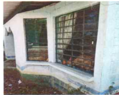
Foto 4: Pintura deteriorada en todo el centro educativo
