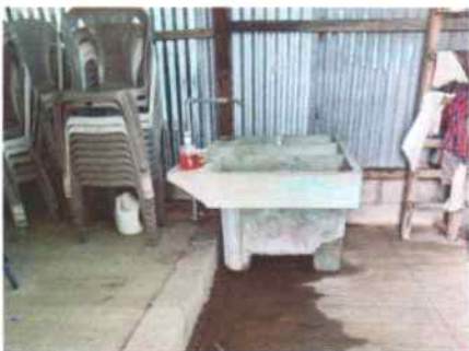
Foto7: Pila de cemento en mal estado
