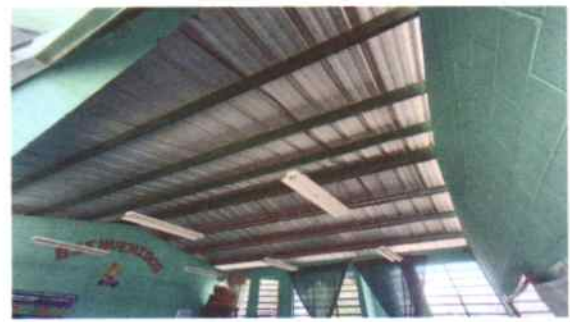
Foto 6: Sistema eléctrico en mal estado y existe circuito
