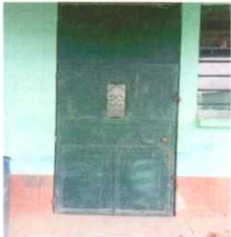
Foto1: Puertas de metal en mal estado
