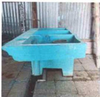
Foto 7: Pila de cemento instalada
