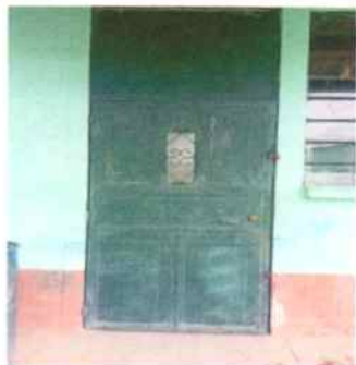
Foto 1: Puertas de metal en mal estado
