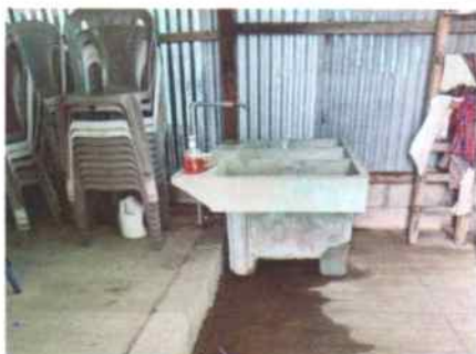
Foto7: Pila de cemento en mal estado
