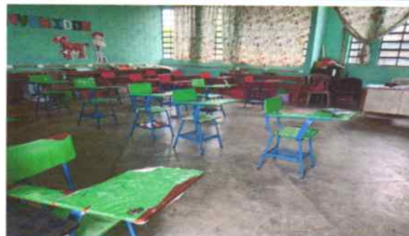
Foto 2: Piso de cemento líquido deteriorado
