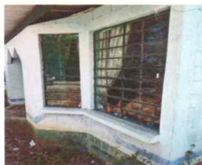
Foto 4: Pintura deteriorada en todo el centro educativo
