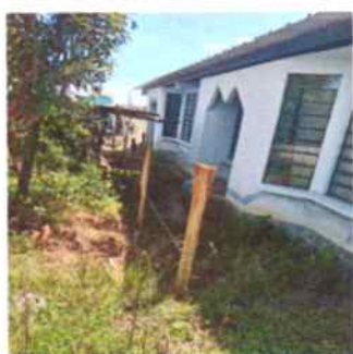
Foto 5: Muro perimetral en mal estado inseguro para aulas ventanales muy grandes
