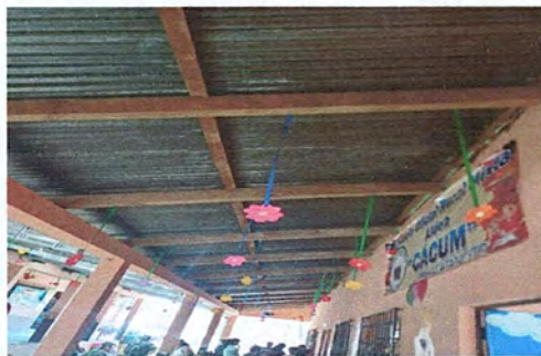
Foto 5: Estructura de soporte de madera deteriorada
