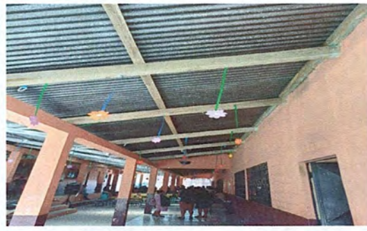
Foto 4: Estructura de soporte de madera deteriorada
