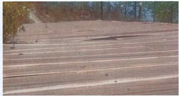
Foto 2: Cubierta de lámina deteriorada
