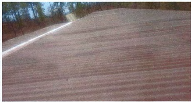
Foto 3: Cubierta de lámina deteriorada
