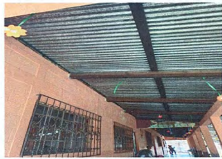
Foto 6: Estructura de soporte de madera deteriorada
