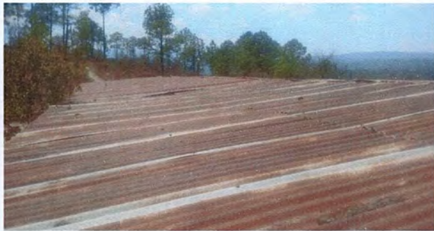
Foto 1: Cubierta de lámina deteriorada
