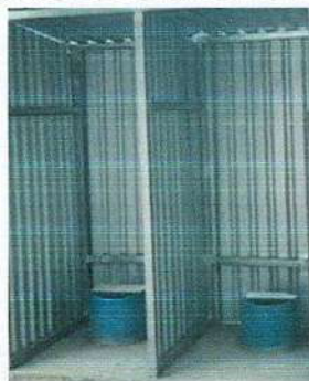
Foto 8: Inodoros en mal estado
