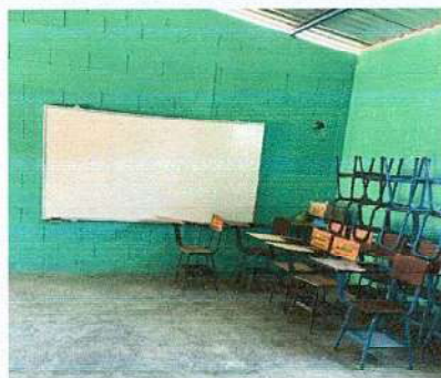
Foto 10: Instalación de eléctrica en mal estado
