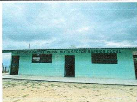
Foto 12: Repello en mal estado
