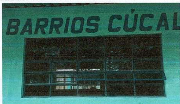
Foto 3: Ventanas de metal en mal estado e inseguras falta de balcones
