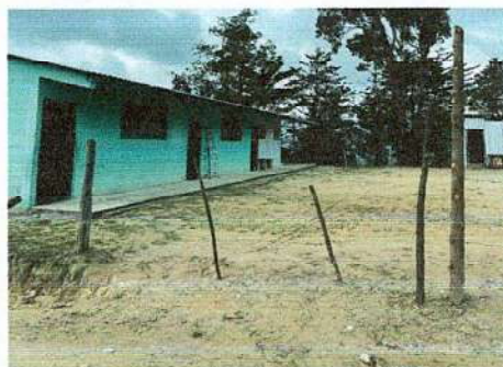
Foto 2: Portón en mal estado e inadecuado
