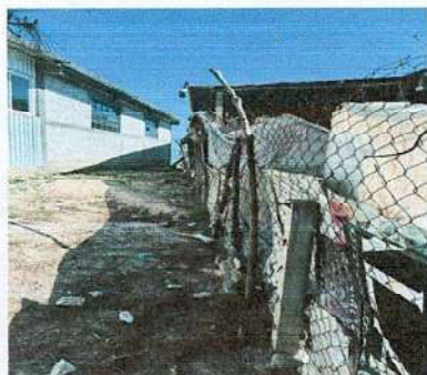
Foto 9: Muro perimetral en mal estado
