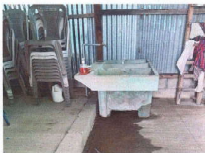
Foto7: Pila de cemento en mal estado
