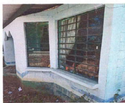
Foto 4: Pintura deteriorada en todo el centro educativo
