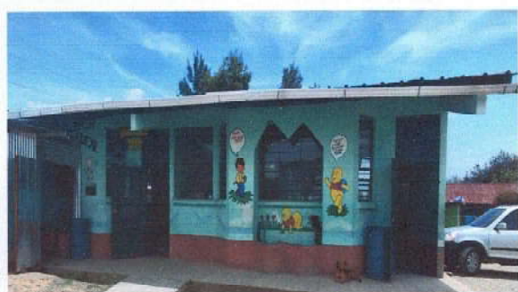
Foto 3: Canal de PVC en mal estado
