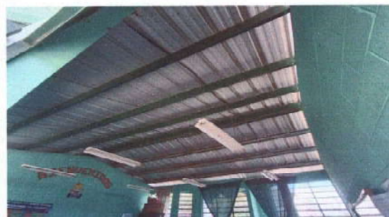
Foto 6: Sistema eléctrico en mal estado y existe circuito
