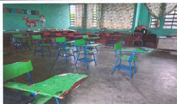
Foto 2: Piso de cemento líquido deteriorado
