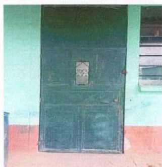
Foto1: Puertas de metal en mal estado
