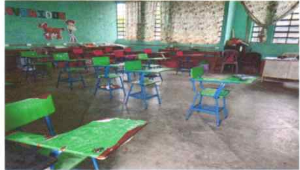
Foto 2: Piso de cemento líquido deteriorado
