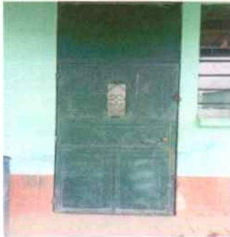
Foto1: Puertas de metal en mal estado
