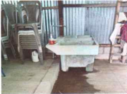
Foto7: Pila de cemento en mal estado
