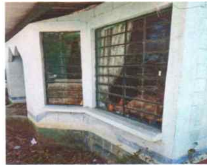
Foto 4: Pintura deteriorada en todo el centro educativo
