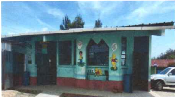
Foto 3: Canal de PVC en mal estado
