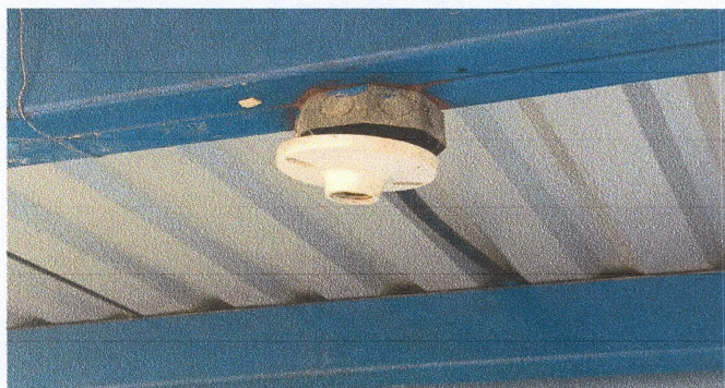
Foto 1: Sustrucción de sistema eléctrico en malas codiciones.
