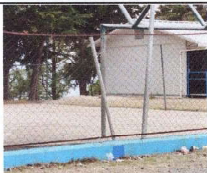
Foto 5: Deterioro de malla galvanizada y tubo HG.
