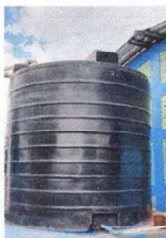
Foto7: Depósito de agua deteriorado y mejoramiento de base.
