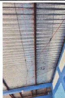
Foto 6: Cableado eléctrico en mal estado y en peligro.
