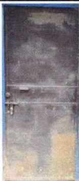
Foto 1: Puertas en mal estado y deterioradas en servicios sanitarios.
