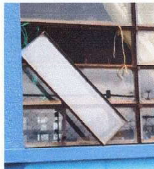
Foto 2: Deteriorado en vidrios de ventanas de clase y servicios sanitarios.
