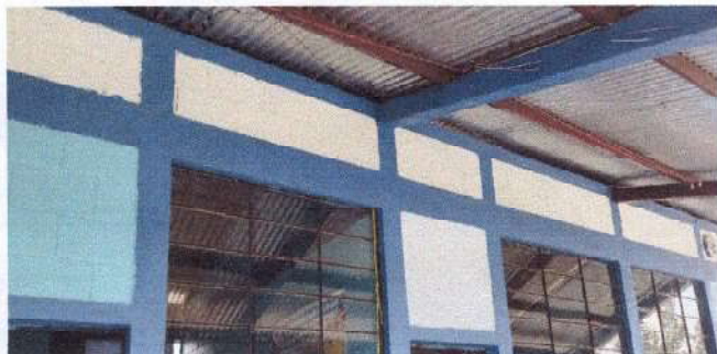
Foto 3: la pintura está deteriorada, es necesario volver a pintar
