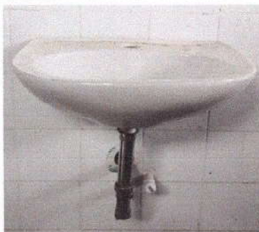
Foto 4: Llave de paso en mal estado y deterioro de mezcladora lavamanos y grifos.
