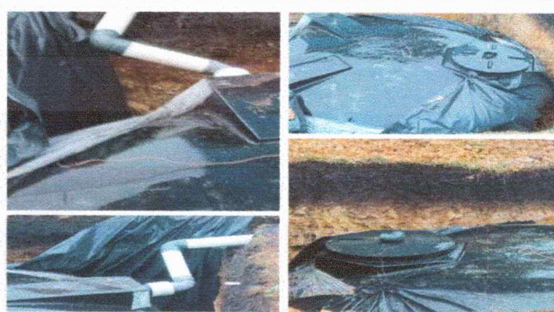
Foto 9: INCORPORACIÓN DE BIODIGESTOR AUTOLIMPIABLE
