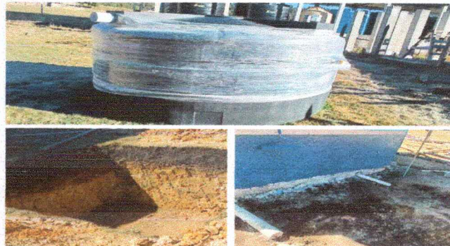
Foto 9: INCORPORACIÓN DE BIODIGESTOR AUTOLIMPIABLE
