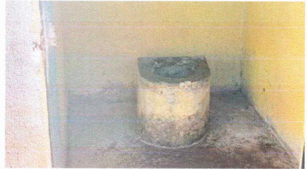
Foto 9: INCORPORACIÓN DE BIODIGESTOR AUTOLIMPIABLE
