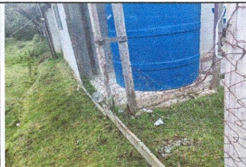
Foto1: SUSTITUCIÓN DE MALLA DETERIORADA; OXIDADA Y MADERA EN MAL ESTADO
