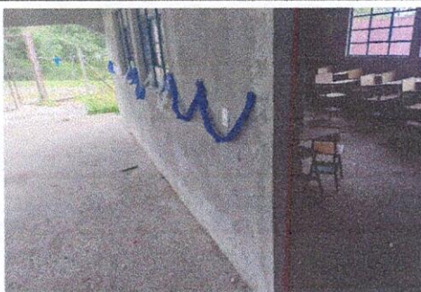
Foto 3: PISO EN MAL ESTADO
