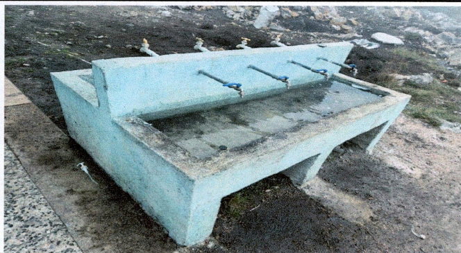
Foto 11: Sustrucción de llave de chorro de lavamanos
