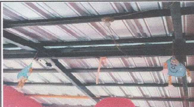
Foto 2: Se cambiara todo el tendido electrico (focos)
