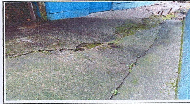
FOTO 12: LOSA EN MAL ESTADO
