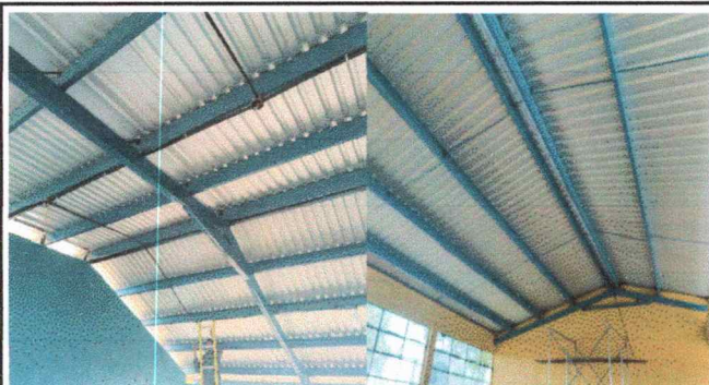
Foto1: REGLON: CUBIERTA DE LAMINA
