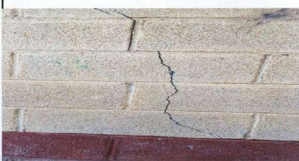
Foto 5: AGRIETADO DE PAREDES POR EROSION DE SUELO
