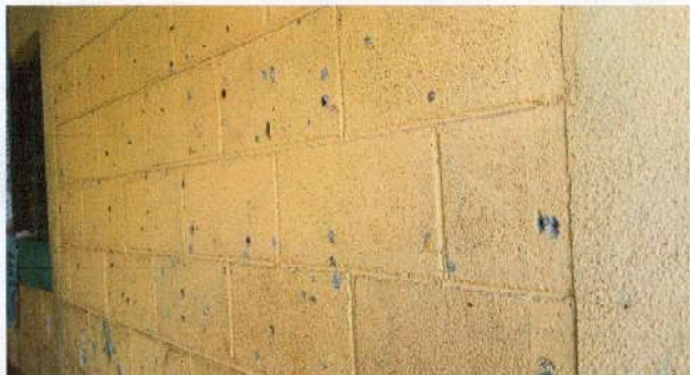
Foto 1: PINTURA DETERIORADA EN MUROS
