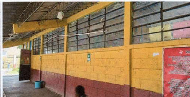
Foto 2: PINTURA EN EXTERIORES EN MAL ESTADO
