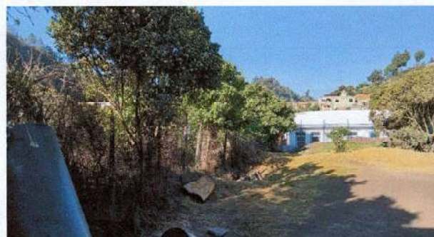
Foto 2: CERCO PERIMETRAL EN MAL ESTADO
