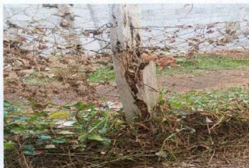
Foto 3: POSTES YA COLAPSADOS
