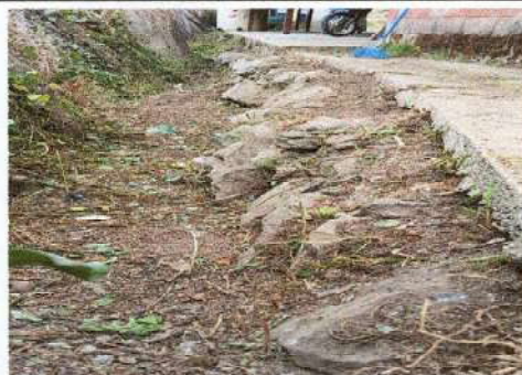
Foto 4: MURO DE CONTENCION EN MAL ESTADO
