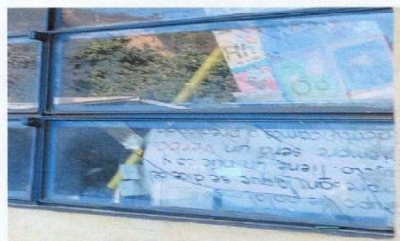
Foto 4: vidrios dañados por falta de balcones
