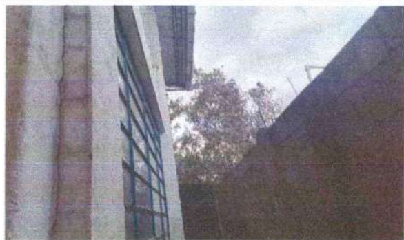
TECHO PASILLO HACIA COCINA: Complemento derivado de lluvia cae directa al pasillo.
