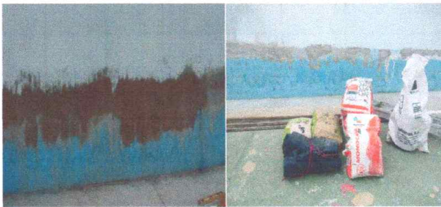
Foto 11: Cernido en muros
