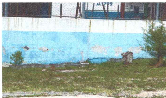
Foto 11: Cernido en muros
