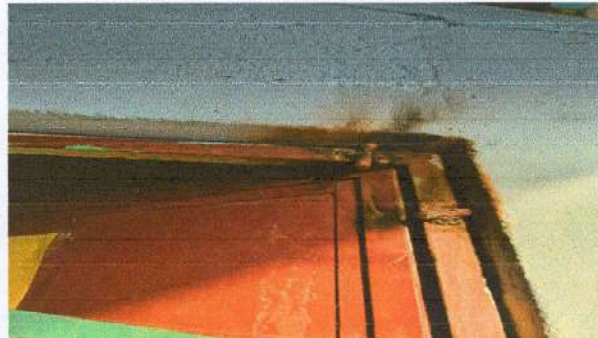
Foto 4: Puertas de metal
